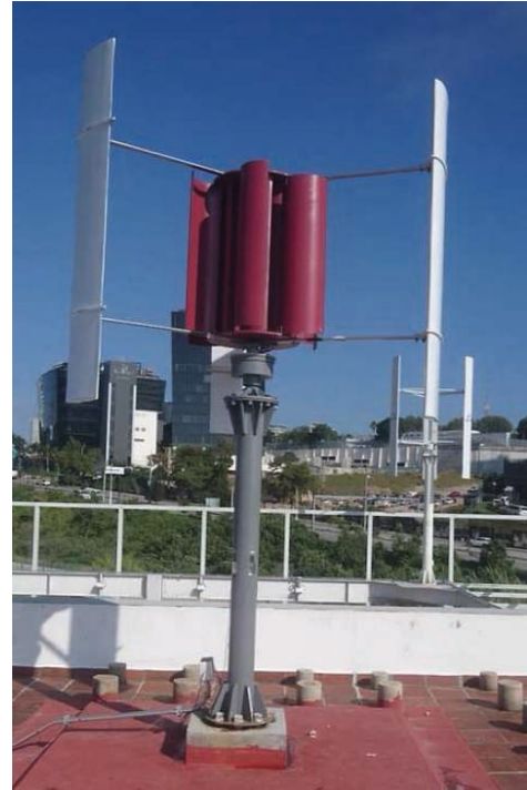
Figura 16. Turbina con implementaciones de mejora.
