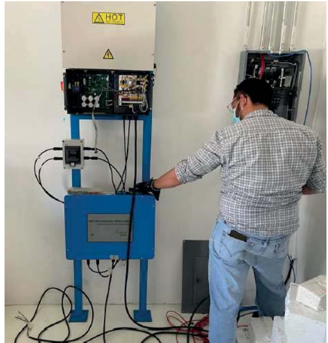
Figura 33. Conexión eléctrica y de comunicación de la turbina
