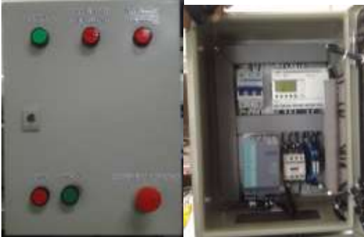
Figura 19. Distribución Interna del tablero de control y distribución externa del tablero de control de la máquina para la producción de tlacoyo.
