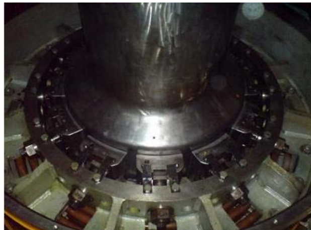
Figura 1 – Cojinete Guía de una turbina hidráulica de eje vertical
