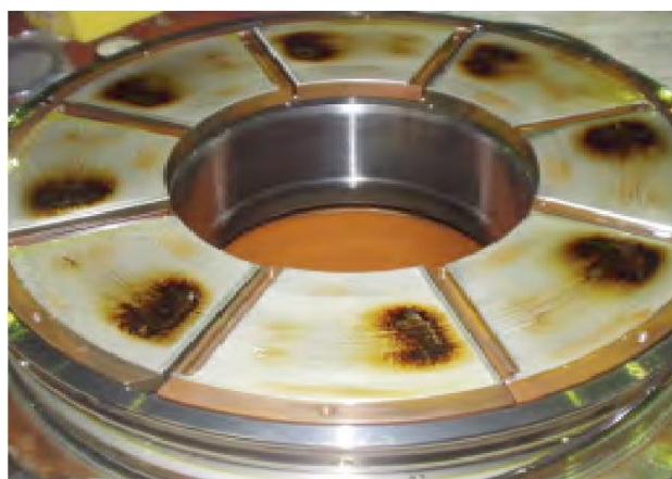
Figura 2 – Cojinete de Carga de una turbina hidráulica, en donde se aprecian las zonas de desgaste
